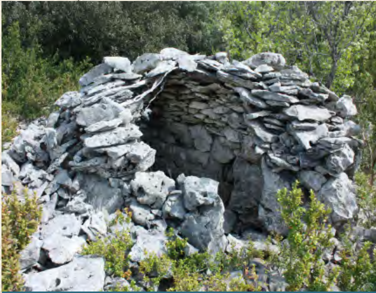
21 Rabou. Cabane isolée, à voûte en partie effondrée.
